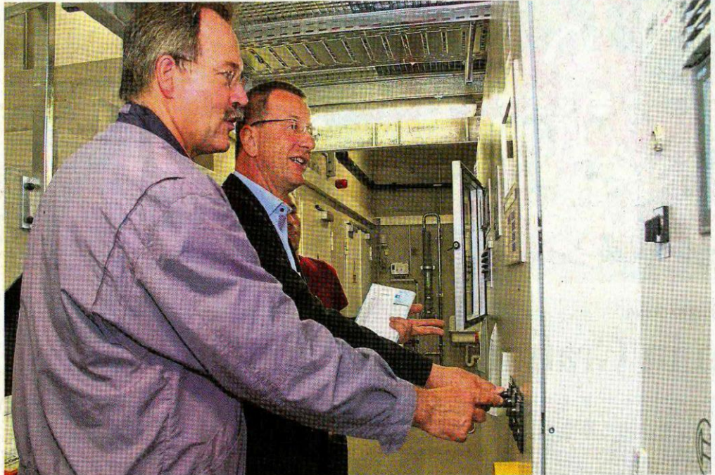
Los geht's: OB Andreas Haas (r.) und Energierreferent Christian Ganslmeier nehmen das Blockheizkraftwerk in Betrieb.
