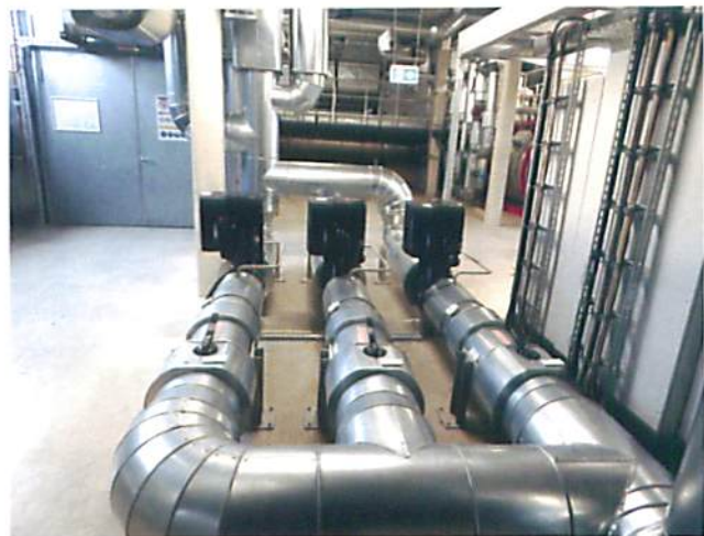
▲ Netzpumpen in der Energiezentrale Fotos: Team für Technik GmbH
