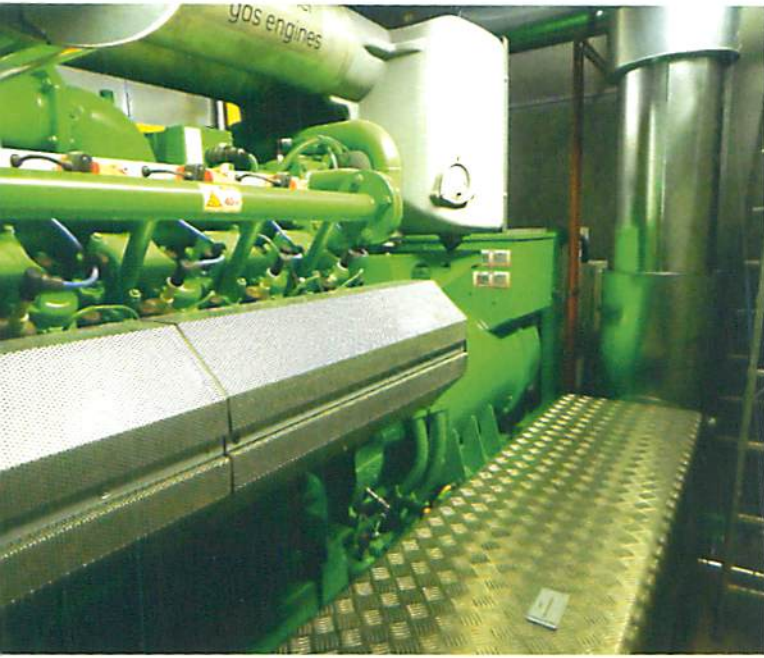
◀ BHKW-Anlage mit einer elektrische Leistung von 527 kW Foto: Team für Technik GmbH
