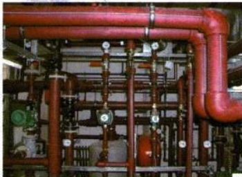
Das Rohrsystem Ketrax kam bei der Klimatisierung der Stadtwerke München zum Einsatz
